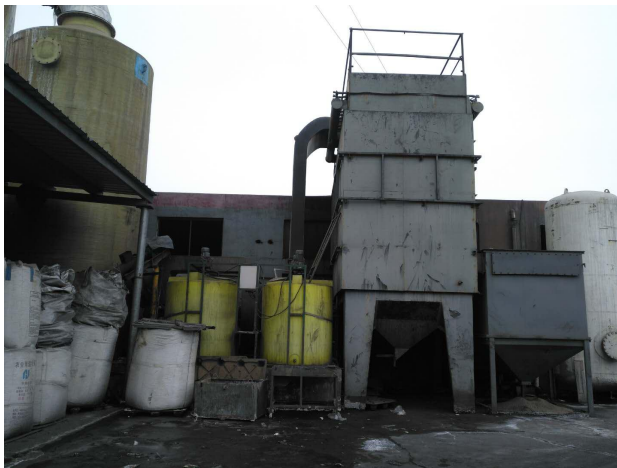
脉冲布袋除尘+H 2 O 2 溶液喷淋塔+钠钙双碱法
