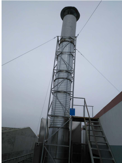
15m 高排气筒
